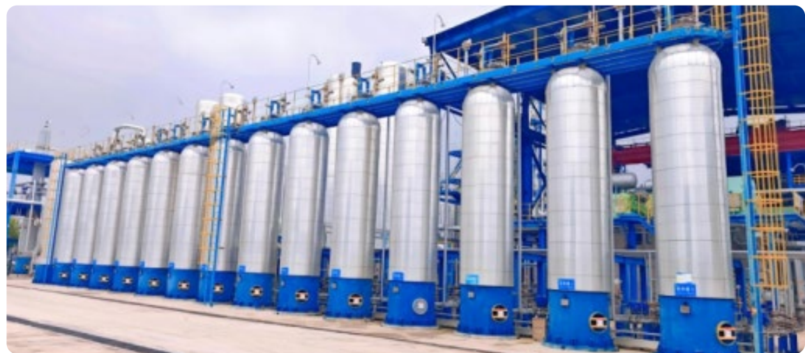
全球最高压力变压吸附提氢装置
