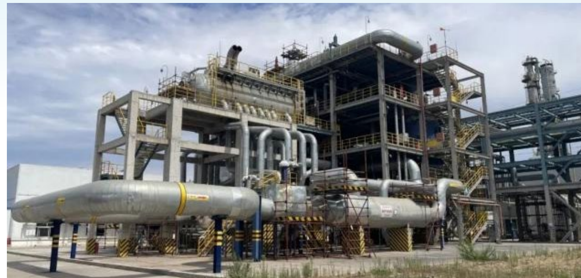
煤制天然气甲烷化装置
